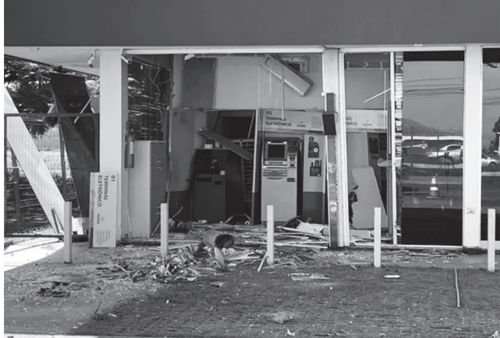
O local em que estava o caixa eletrônico ficou destruído
