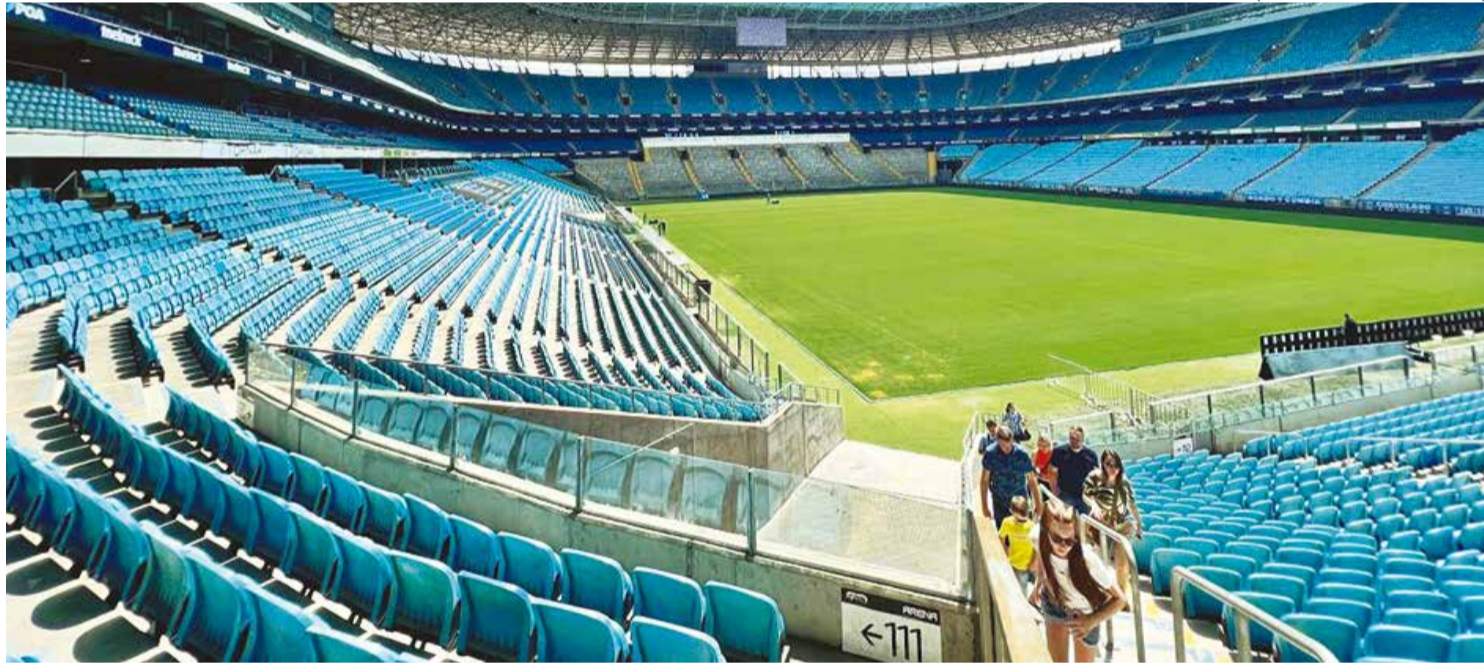
Arena Grêmio se recupera de alagamento, mas ainda não tem condições de uso para jogos
